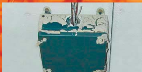
Ответственные коробки с подключенными кабелями после теста
