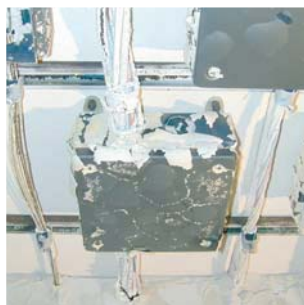
Ответственная коробка с подключенными кабелями после испытаний..
